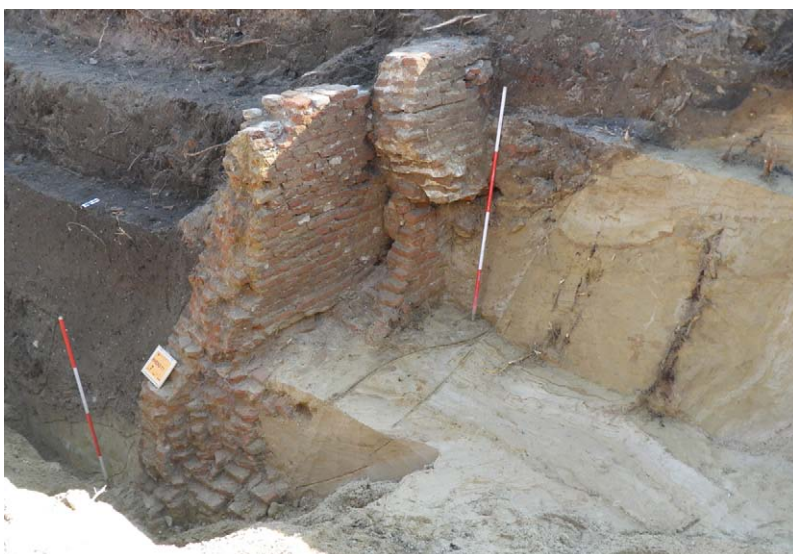
Afb. 6.9 Keermuur zuidelijk plangebied, gezien vanuit het noordwesten (stadszijde) met de oorspronkelijke keermuur (spoor 1) met de insteek (spoor 7.1), de ophoging (spoor 3), die naar de gracht overhelde en de insteek van spoor 3 (spoor 9.1). Om te voorkomen dat het bovenste deel van de muur zou omvallen werd naderhand een brede steunbeer (spoor 5) gebouwd (vergelijk afb. 6.2 en 6.3) (Foto ADC ArcheoProjecten).
